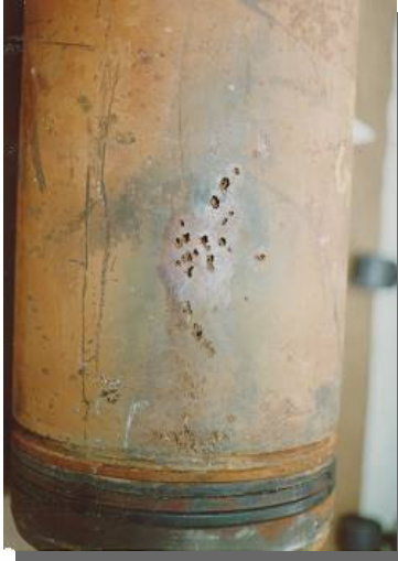
Çukur oluşması hasarı
